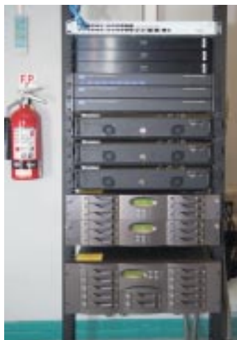
Rack de equipos.
